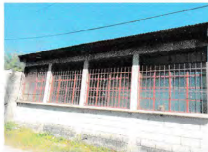
Foto 2: la pintura con el paso del tiempo y el clima se deterioro
