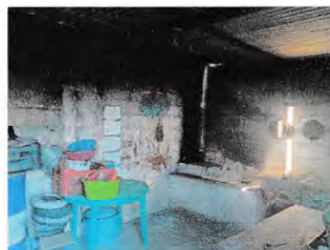
Foto 8: Estufa rural en mal estado, tiene mas de 10 años funcionando, por eso se solicita la colocacion de azulejo para mejorar su apariencia y funcionalidad
