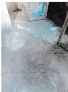
Foto 1: instalacion de piso de granito, solo cuenta con contrapiso de concreto en el area de cocina
