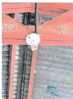
Foto 3: Lámparas en mal estado
