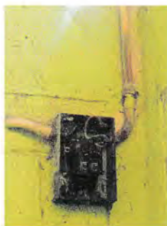
Foto 5: El tendido electrico presenta fallos, y cortos en sus circuitos
